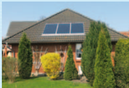
Hybridanlage zur Trinkwassererwärmung und luftseitiger Heizungsunterstützung: 150 % Leistung im Vergleich zu herkömmlichen Flachkollektoranlagen
